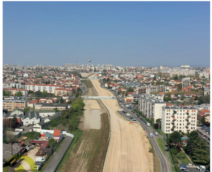
Autoroute entièrement démolie – Mai 2021
